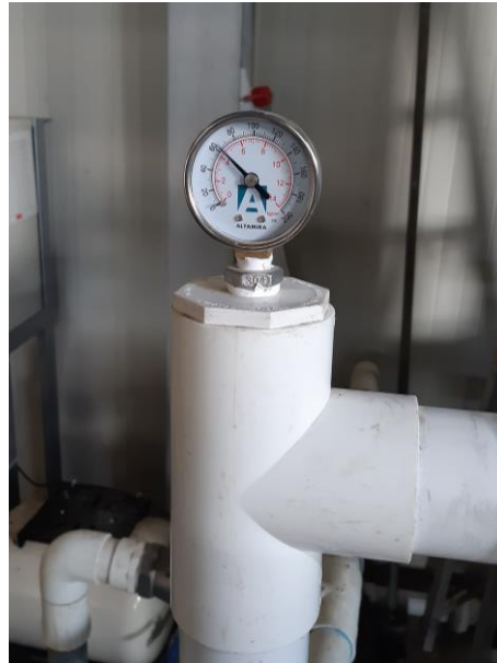
IMAGEN No. 4. Presión de entrada del sistema de bombeo general.
